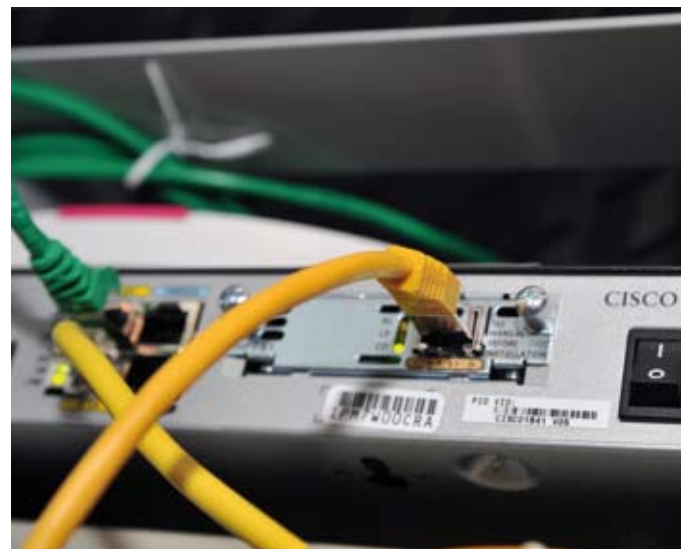
Eine MPLS-Leitung und eine SDSL-Backup-Leitung verbinden das Kreiskrankenhaus Stollberg mit dem Siemens-Rechenzentrum in Berlin.
