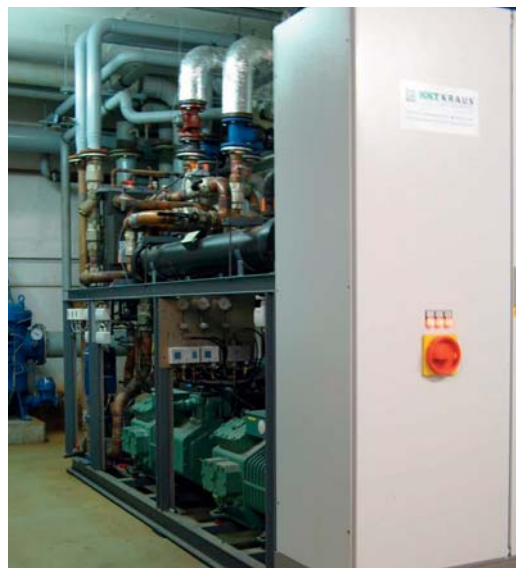
Wärmepumpe zur Rückgewinnung von Abwärme aus dem Kühlwasserkreislaufsystem
